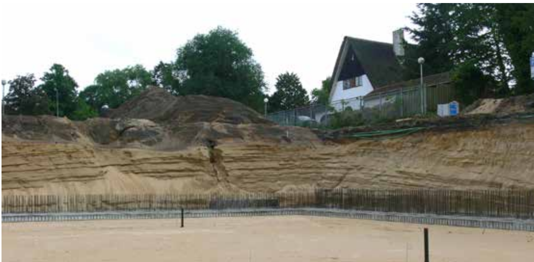
Afbeelding 6: smeltwaterdelta aan de zuidzijde van het Mediapark. Het deltalichaam is in twee richtingen aangesneden bij het graven van de bouwput. Kenmerkend voor deze delta zijn de evenwijdig lopende, hellende zandlagen. Foto: Sander Koopman.
